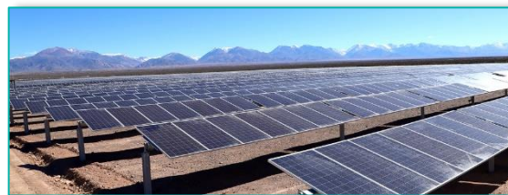
Figura 13: Parque Solar Iglesia-Estancia Guiñazul, ubicado en la provincia de San Juan [18].
