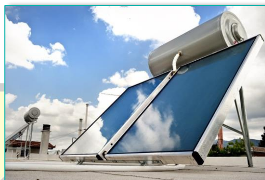
Figura 8: Panel solar térmico [12].
